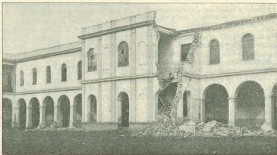
Messico - Lato ovest del Collegio Salesiano dopo il terremoto.
